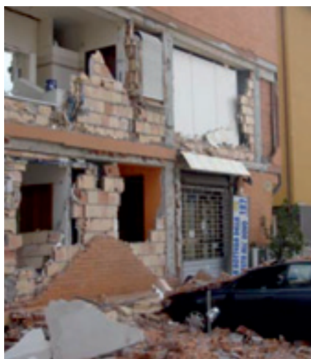
Fig. 2 - Danni alle tamponature durante le ricognizioni dopo il terremoto di L'Aquila.
